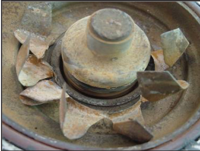
Corrosión de la Propela
