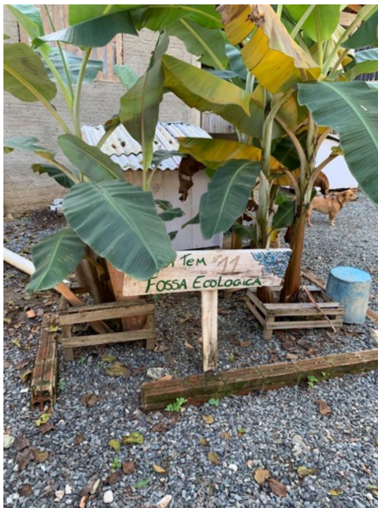
Figura 5: Fossa ecológica construída em cada moradia na comunidade Nova Esperança
